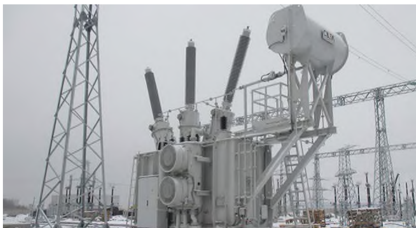
Рисунок 3 – Трансформатор, установленный на Курской АЭС
